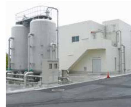
オゾン活性炭設備
