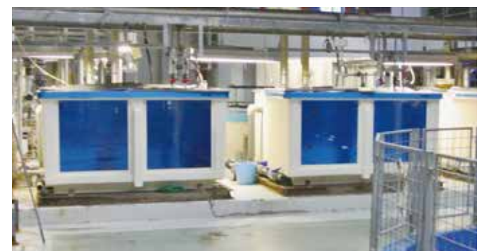
循環設備(水族館)
