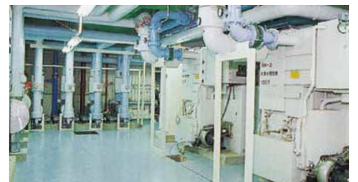
循環設備(温水プール)
