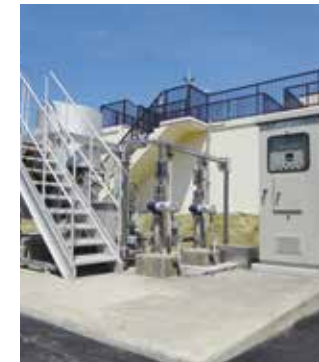
粉末活性炭注入設備
