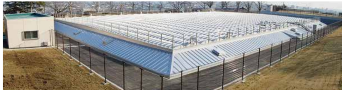
ステンレス鋼製角形配水池
