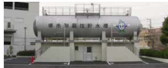
耐震性貯水槽
