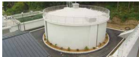
PC製配水池
