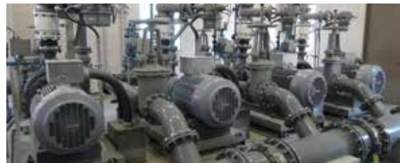
送水ポンプ設備
