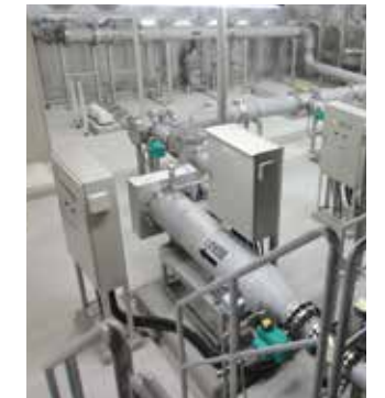
紫外線処理設備
