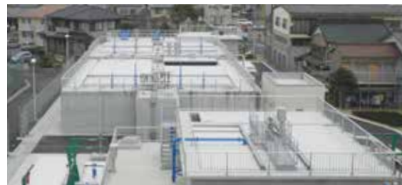
凝集沈澱急速ろ過設備
