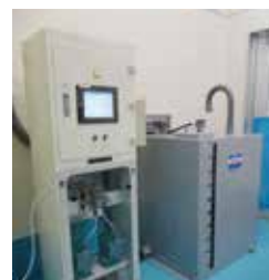
薬品注入設備
