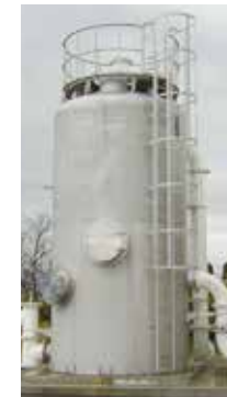
エアレーション設備
