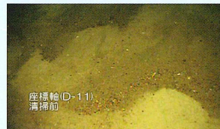
底版に堆積した沈澱物(砂など)
