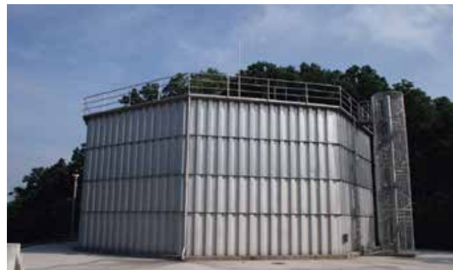
配水池 1,600m³(八角形2槽式)
